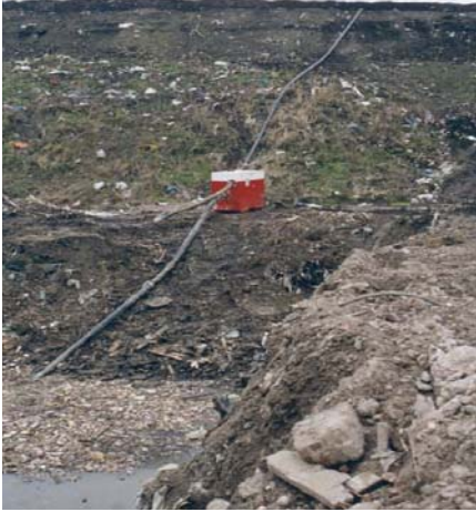
Eine Betsy auf einer Mülldeponie. Sie fördert Sickerwasser aus einem Sumpf.
